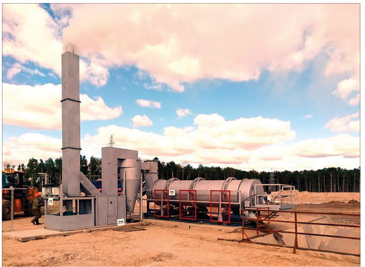
Установка по утилизации нефтешламов
